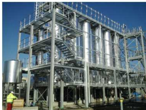
図4 污泥可溶化施設
