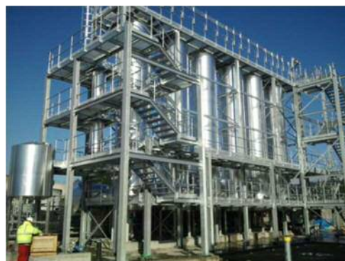
図4 汚泥可溶化施設
