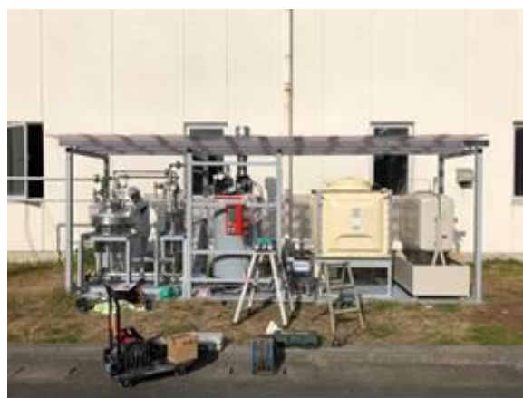
汚泥可溶化装置
