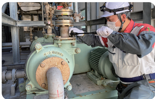
下水処理場だけでなく、ポンプ場の機器も定期的に点検しています
